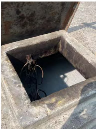
现有项目不含氮废水收集池
