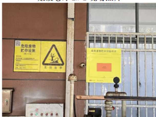
危废仓库 2#-2 现场照片
